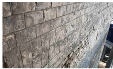
패러핏 주변 타일 상세(페인트제거 후)
