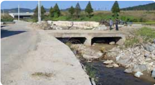
[사진 3-10] 하천기본계획 미수립구간 통수능 부족으로 월류 (전북 익산시 왕궁면 동용리, 왕궁천, 사진: 국토해양부)
