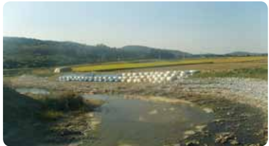
[사진 3-11] 수충부 및 계획홍수위 제방 여유고 부분 피해발생 (전북 익산시 여산면 원수리, 강경천, 사진: 국토해양부)
