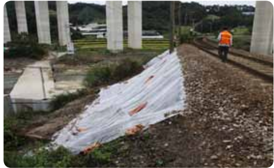
[사진 3-17] 집중호우로 인한 노반 유실 (중앙선, 동화-만중간, 사진: 국토해양부)
