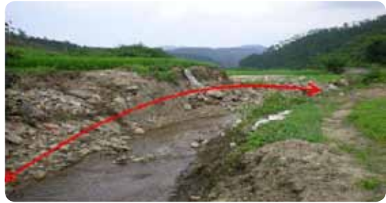
[사진 3-9] 미개수 하천 통수능 부족으로 제방 및 호안 유실 (충남 부여군 은산면 장벌리, 장벌천, 사진: 국토해양부)
