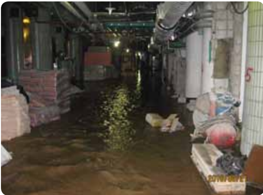
[사진 3-18] 홍대입구역 노면수 유입 (사진: 국토해양부)
