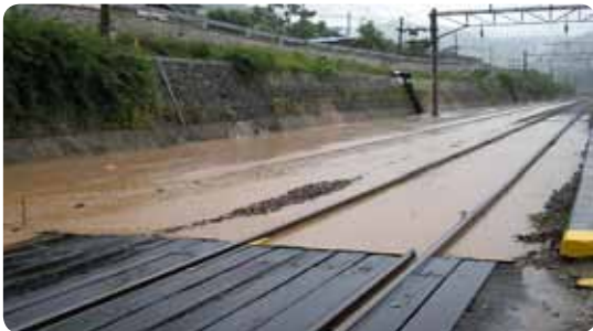
[사진 3-14] 배수로의 통수단면 부족에 의한 운행선 침수 (영동선 현동역구내, 사진: 국토해양부)
