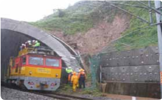
[사진 3-16] 집중호우로 절토사면 토사 유실에 의한 운행 지장 (중앙선, 팔당-운길산간, 사진: 국토해양부)
