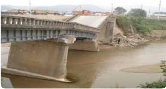
[사진 3-8] 설계기준을 초과한 강우빈도로 교량기초세굴 및 파손 (경기 여주군 여주읍 신진리, 연양천 신진교, 사진: 국토해양부)
